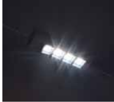
3 / illuminazione stradale (progetto ENEL SOLE)
